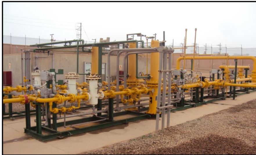
Figura N°07: Vista de Estación de Regulación
