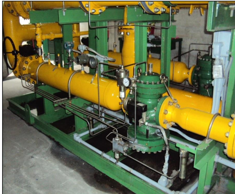
Figura N° 37: Proceso de regulación de gas natural
