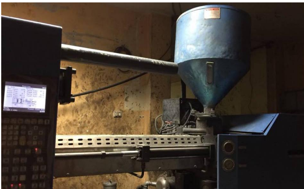
Figura 14. Falta de señalizaciones / Máquina falta de mantenimiento Fuente: Empresa Armo S.A.C.
