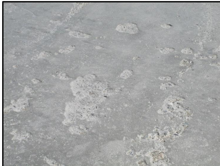
FIGURA N° 13 (DESCASCAMIENTO Y FISURAS CAPILARES)
