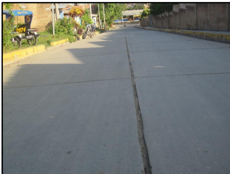
FIGURA N° 07 (FALTA DE SELLO EN JUNTAS)
