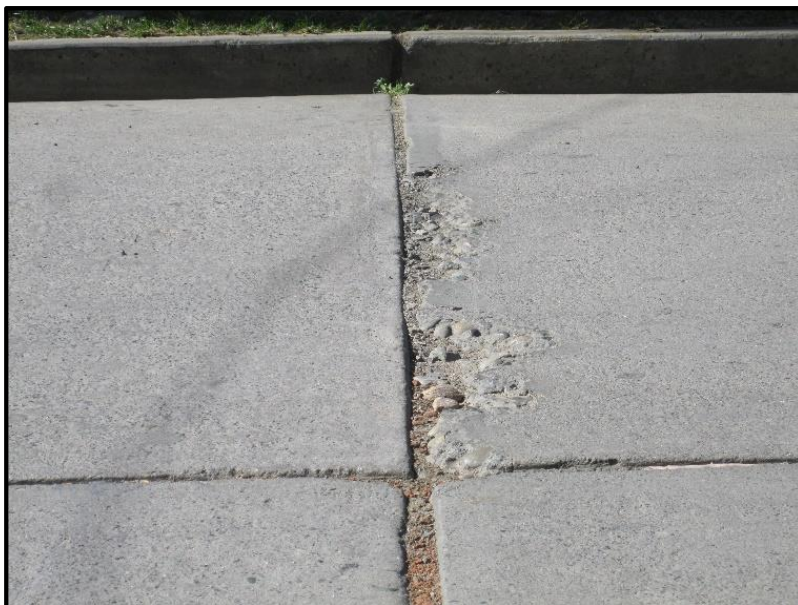
FIGURA N° 06 (DESPORTILLAMIENTOS DE JUNTAS)
