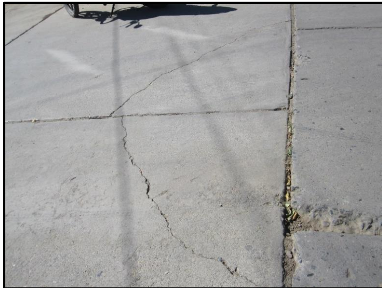
FIGURA N° 03 (ROTURAS O GRIETAS DE ESQUINA)
