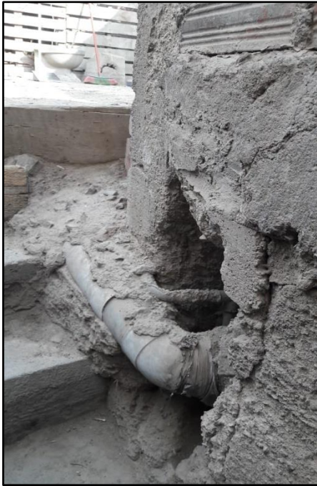
Tubo expuesto en la vivienda.
