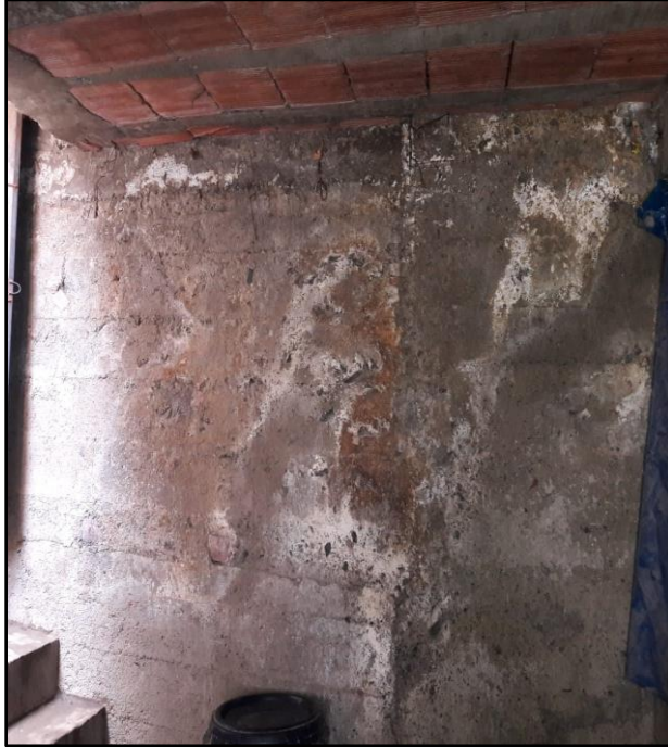
Humedad en los muros.
