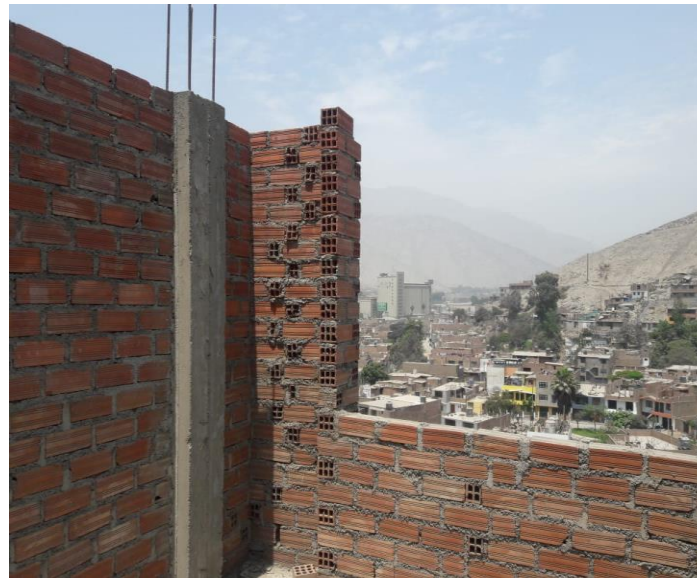
Falta de confinamiento en la parte superior de los muros.
