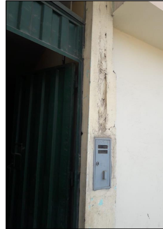
Debilitamiento de una columna principal
