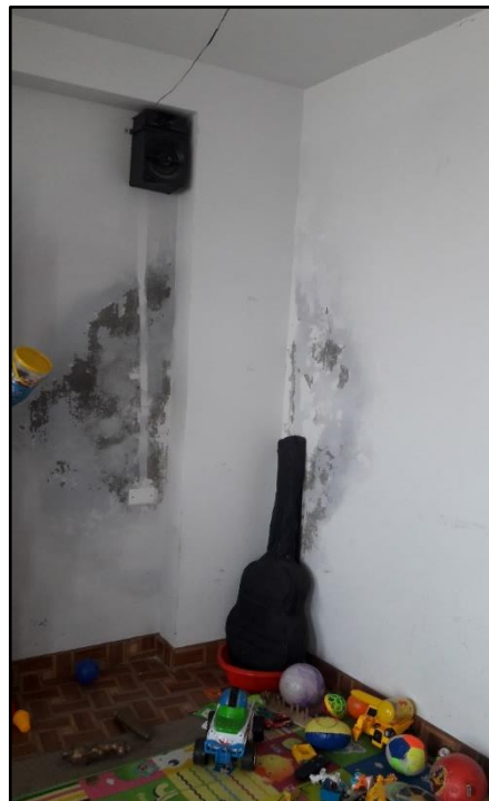
Presencia de Salitre en los muros.
