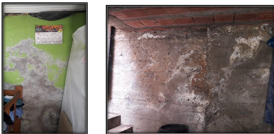
Figura 23: Muro con acabados que contienen salitre
