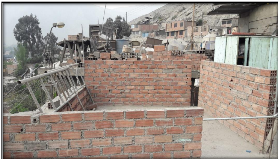
Figura 22: Muros sin arriostramientos
