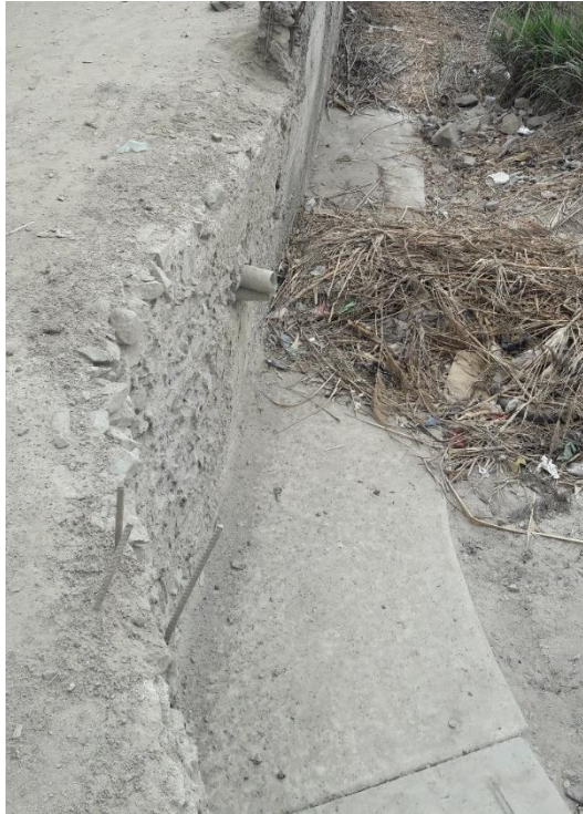
Deterioro del muro de contención
