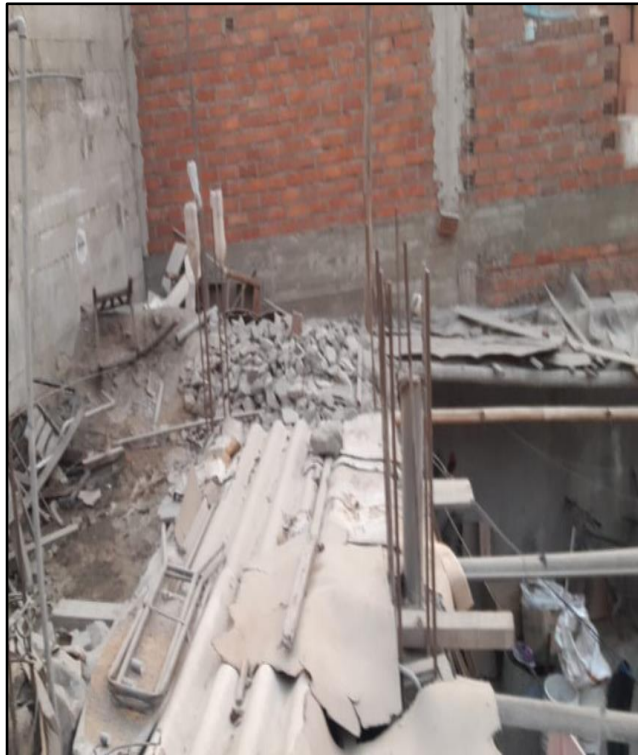
Corrosión de las columnas
