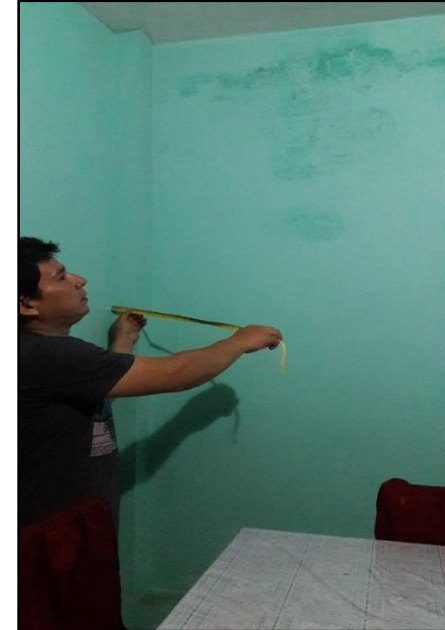
Humedad en las paredes de la vivienda.
