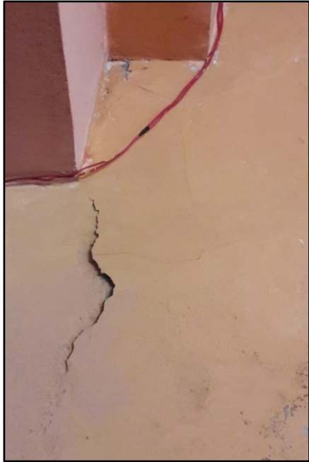
Grietas de la vivienda
