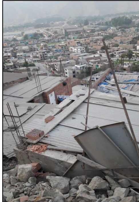
Falta de Confinamiento en la parte superior
