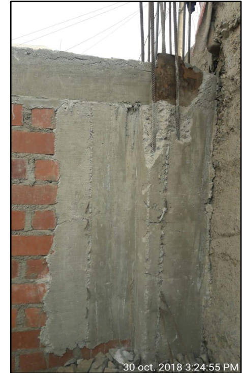
Cangrejas en las columnas.
