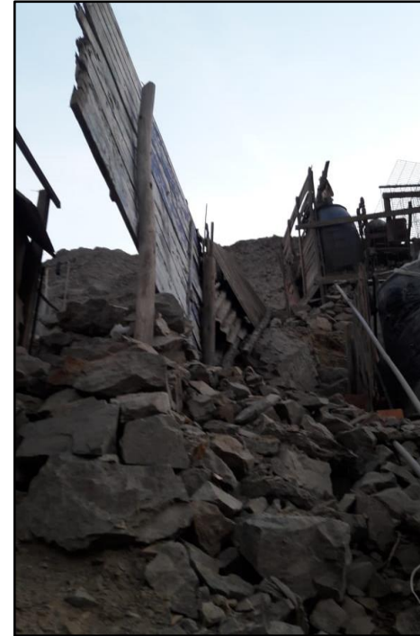
Riesgo de caída de roca.
