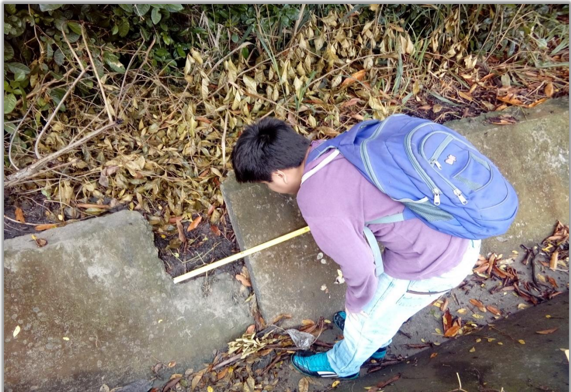
Fotografía N° 02: Se aprecia al tesista midiendo para clasificar severidad del daño de Fracturamiento de la Estructura.
