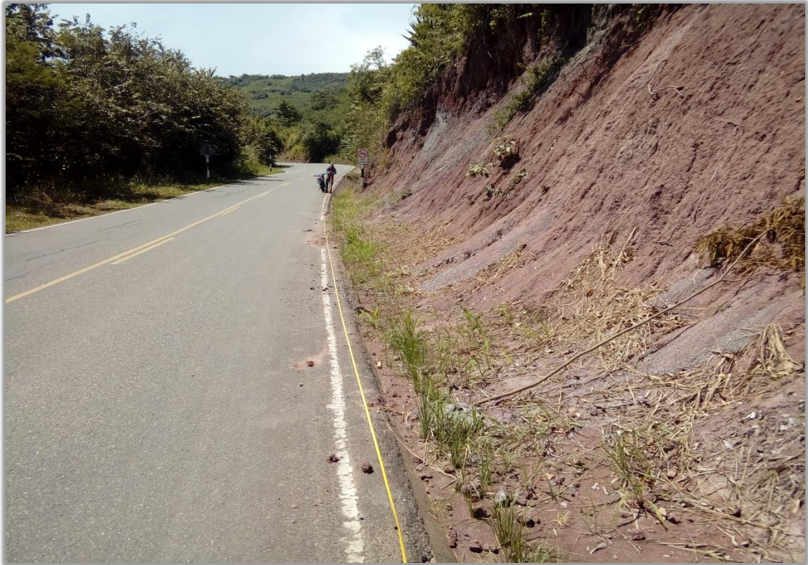
Fotografía N° 03: Se aprecia el daño de Obstrucción.
