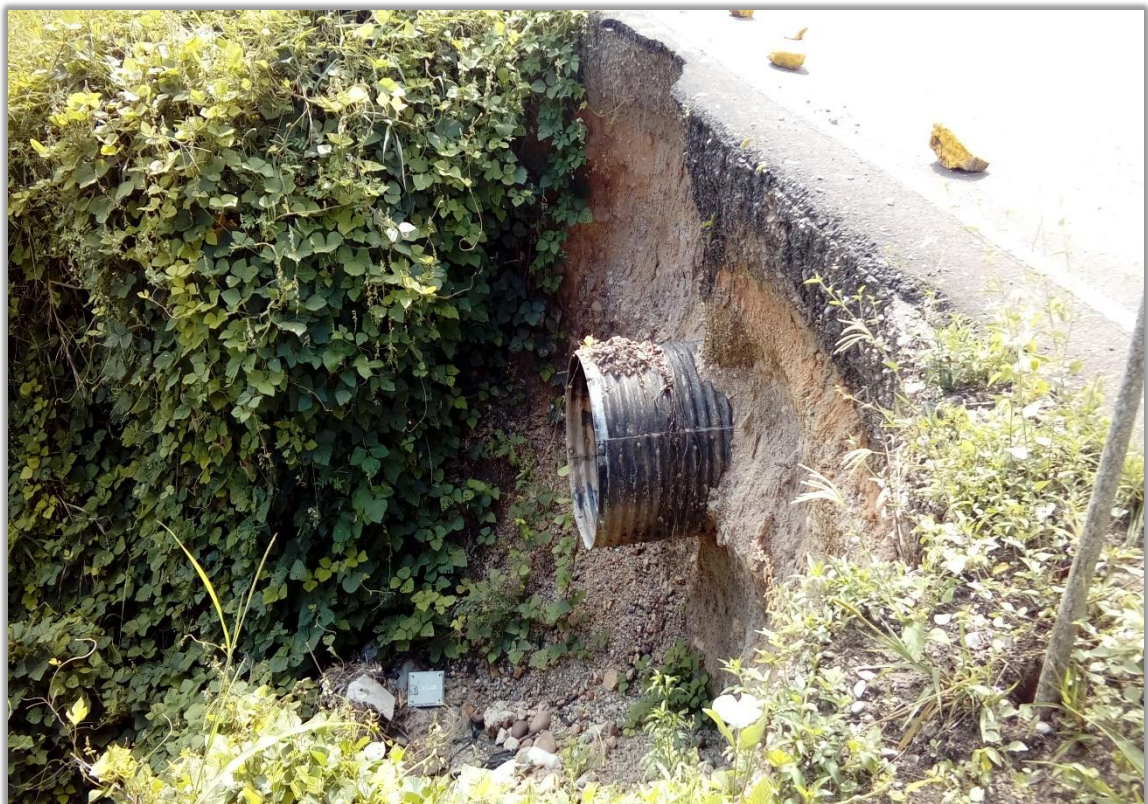
Fotografía N° 04: Se aprecia la Estructura de Salida con Socavación del Concreto y Suelo de Fundación de Aletas, solado y/o Muro Cabezal.
