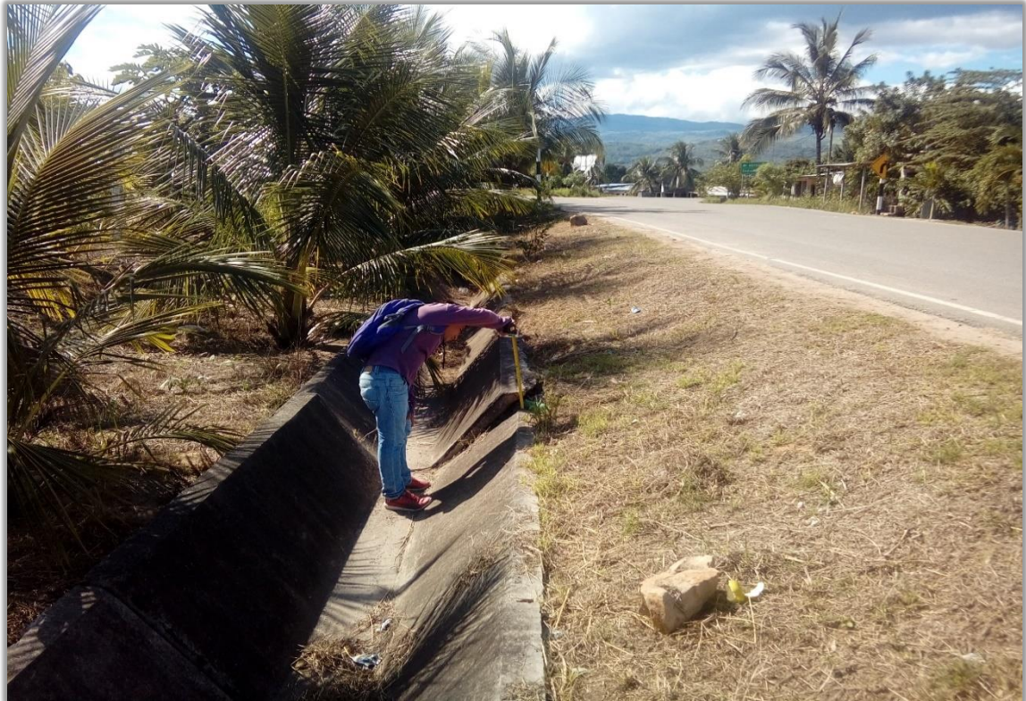
Fotografía N° 01: Se aprecia al tesista midiendo para clasificar severidad del daño de Escalonamiento.
