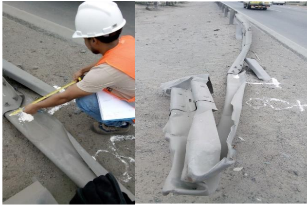
Figura 17: Daño registrado por impacto vehicular
