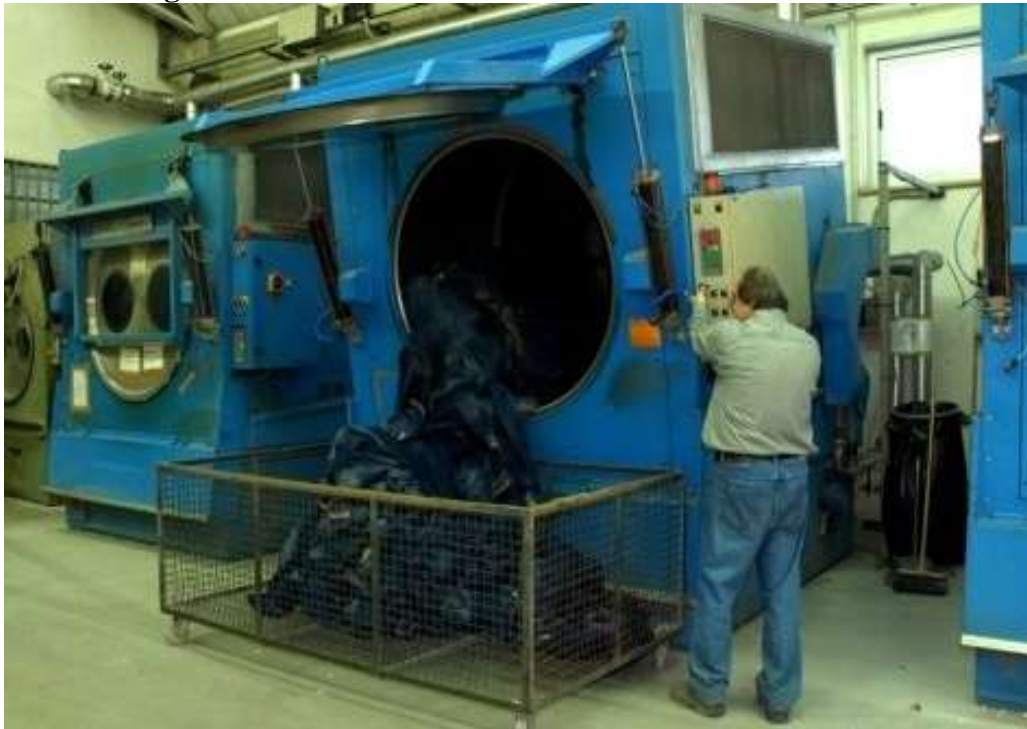
Figura: N° 32 Área de Lavandería: Lavadora Industrial
