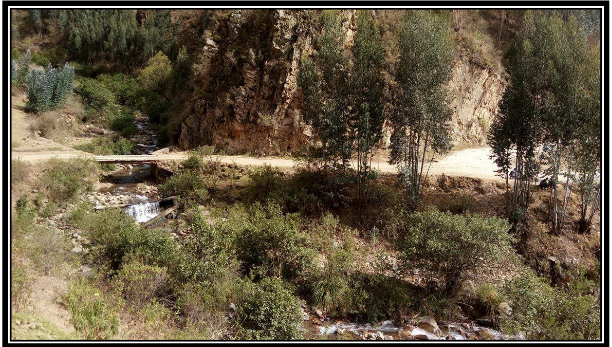
FIGURA N°6 Puente inadecuado para cargas pesadas
