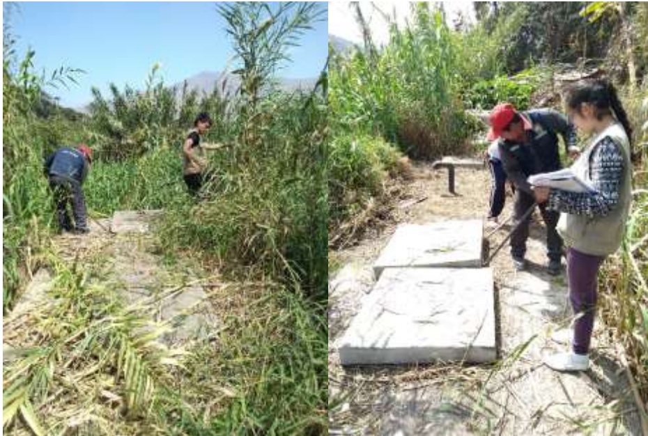
Imagen N° 13: Limpieza y apertura del tanque de sedimentación para realizar la inspección correspondiente.
