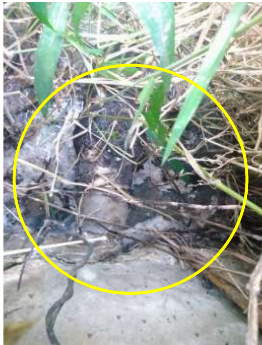
Imagen N° 04: Debido a que no se realizan los mantenimientos adecuados en el pozo sedimentados de sólidos se produjo la ruptura de la tubería ocasionando que las aguas negras se rebosen y contaminen el suelo y el puquio.
