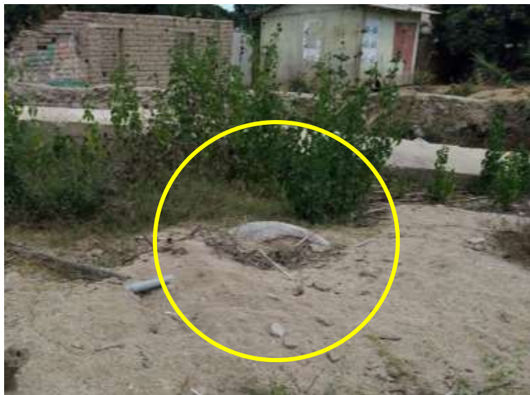
Imagen N° 06: Buzón destruido debido al huaico.
