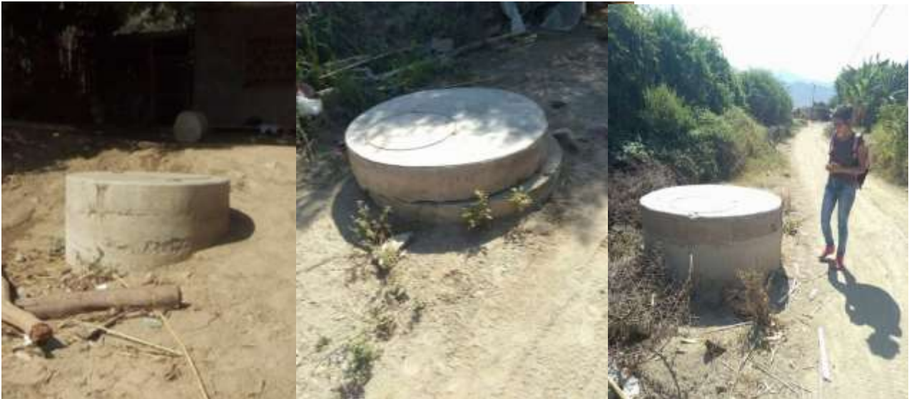
Imagen N° 05: Buzones expuestos debido a que el huaico arrastró parte de la tierra.
