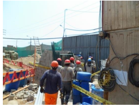
Foto. N° 02 Evacuación del personal
