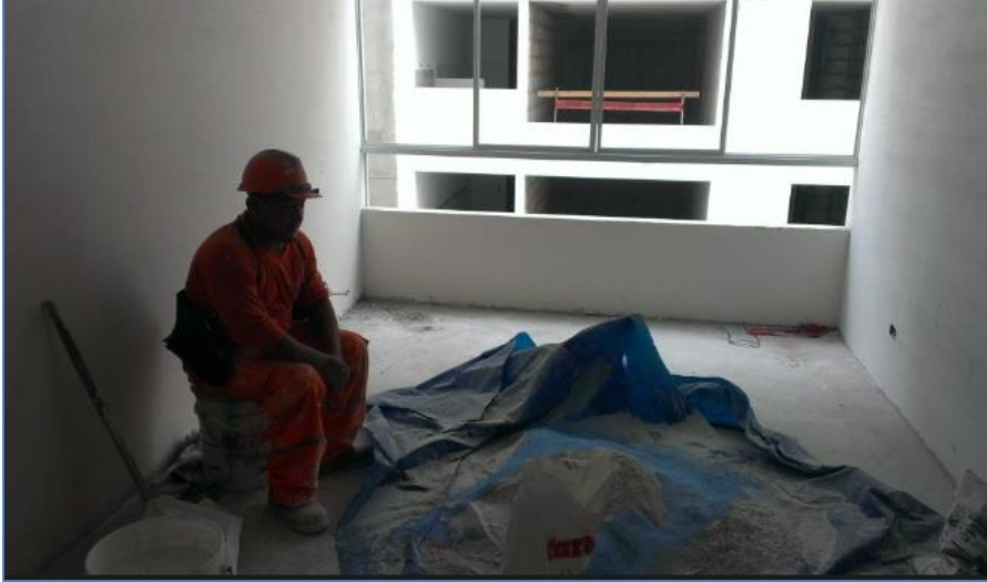
Figura 15. Operación de trabajos con polvo sin protección bucal
