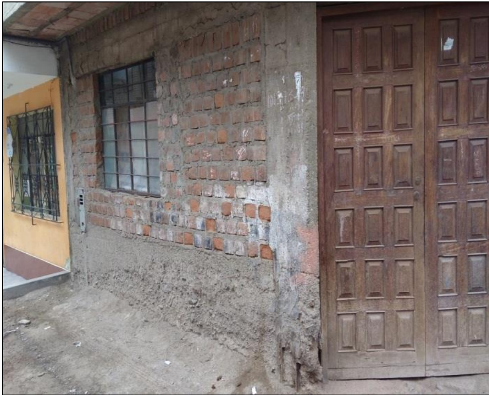
Figura 4: daño estructural de columna y muro. Fuente: elaboración propia.
