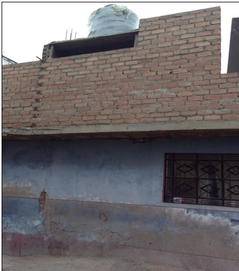
Figura 5: tanque cisterna en el 3er piso. Fuente: elaboración propia.
