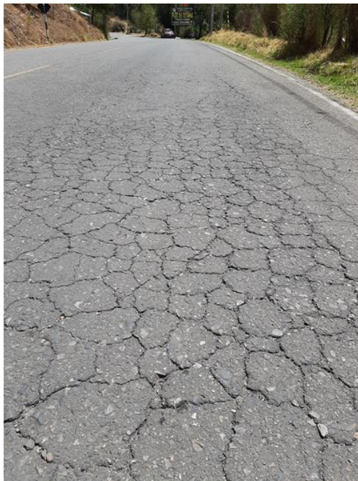
Descripción: Falla de Piel de Cocodrilo con más presencia en el pavimento en estudio.
