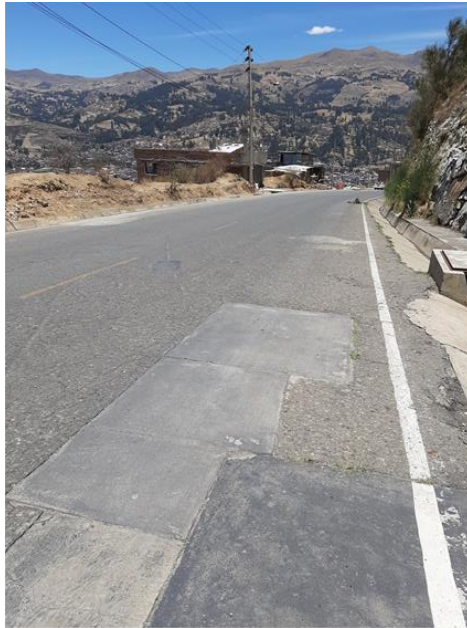
Descripción: Falla por parche
