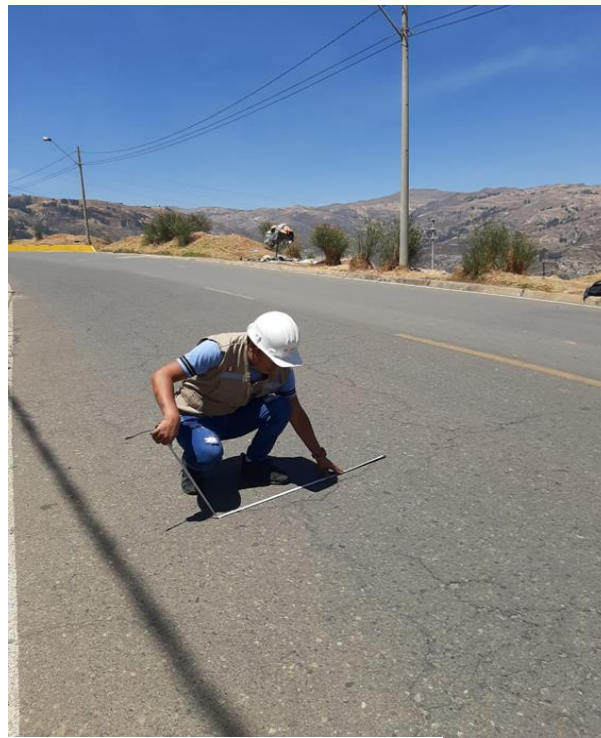
Descripción: Medida de falla con wincha
