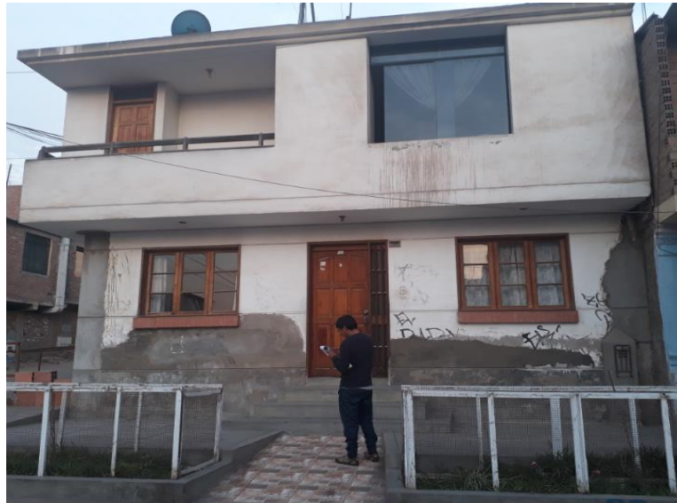
Fig. 3.7 Vivienda con humedad. (Fuente: Propia.)
