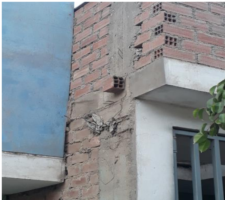
Fig. 3.11 Vivienda con inapropiado diafragma (Fuente: Propia.)
