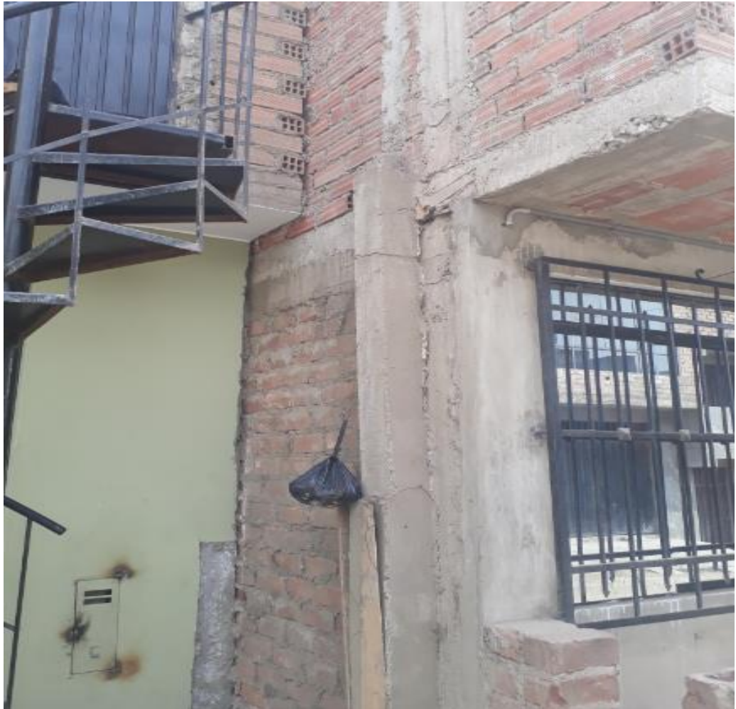
Fig. 3.15 Mala calidad de mano de obra (Fuente: Propia)
