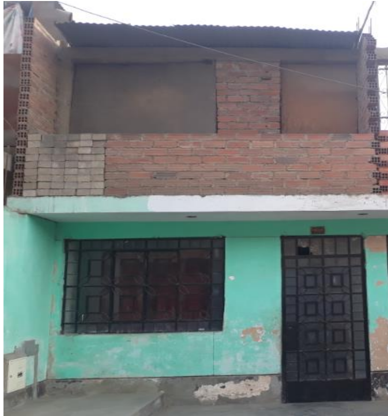
Fig. 3.13 Defectos de la construcción. (Fuente: Propia.)
