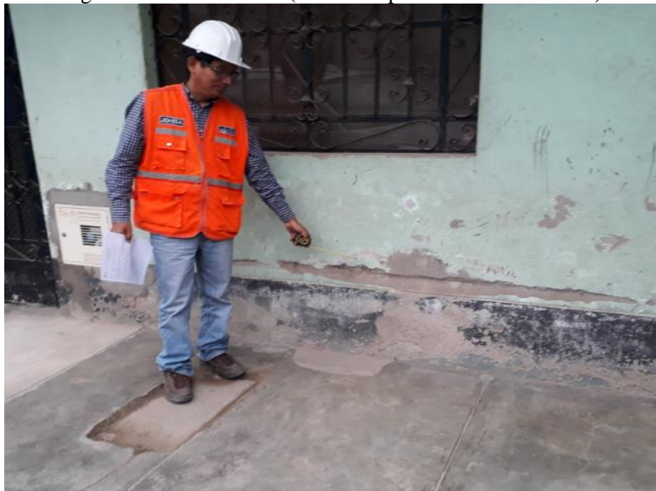
Fig. 2.2 - Vivienda N° 1 (Deterioro por humedad del suelo)
