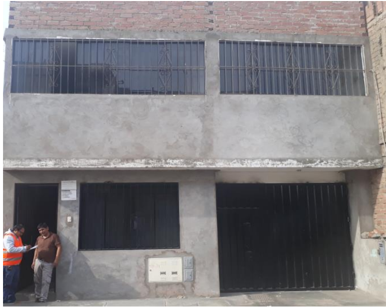
Fig. 3.10 Vivienda sin junta sísmica (Fuente: Propia.)
