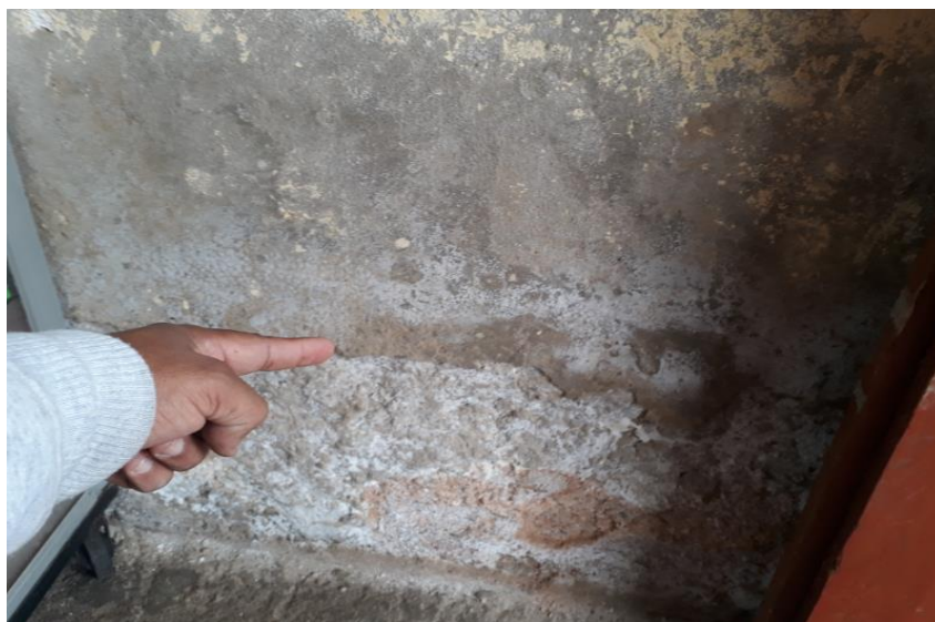
Fig. 3.6 Vivienda con humedad. (Fuente: Propia.)
