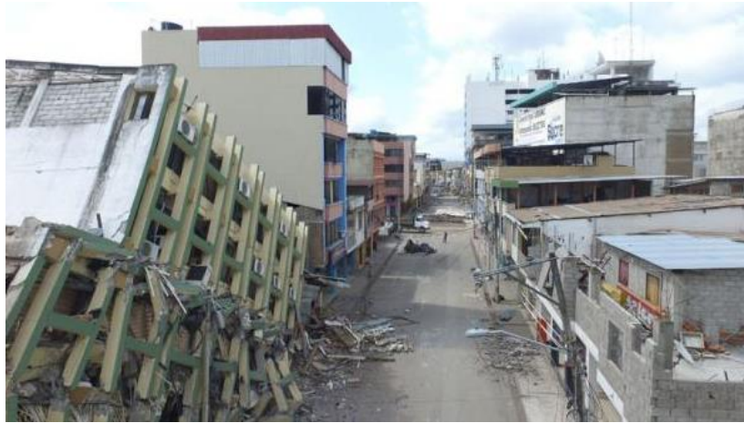
Fíg 1.5. Peligro Sísmico en viviendas de albañilería confinada (Fuente elaboración propia)
