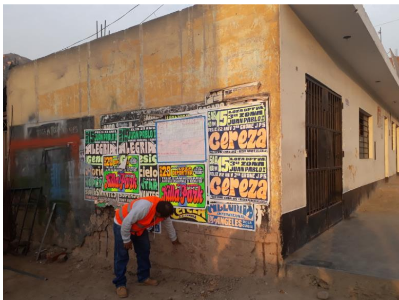
Fig. 3.8 Edificación con erosión en la base. (Fuente: Propia.)
