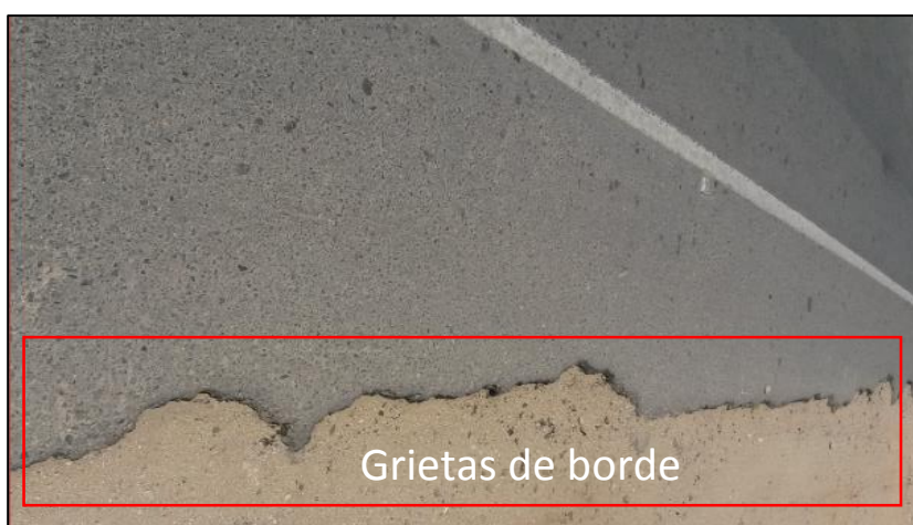
Figura 19. Grietas de borde.
