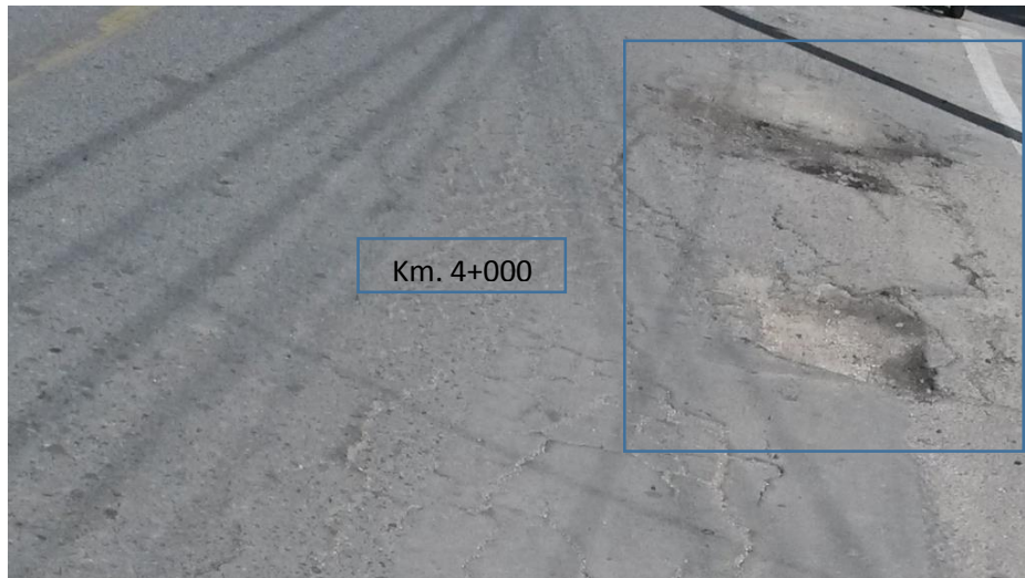
Figura 21. Presencia de baches en la vía Reque - Puerto Eten.
