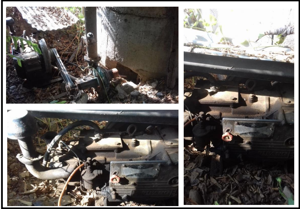
Motobomba de 20 HP existente en el Fundo.
