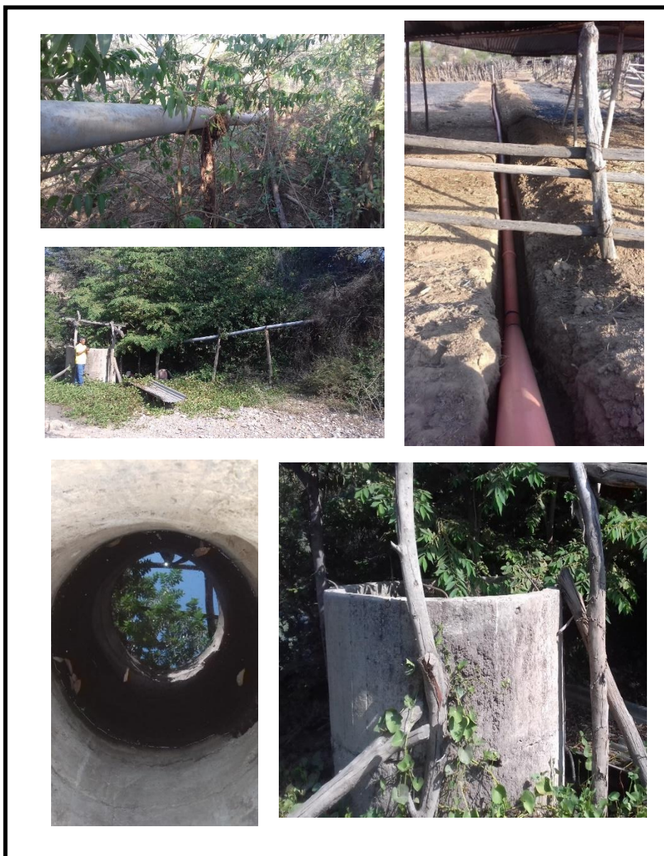
Recorrido de tubería de la zona de succión de la motobomba hacia la poza de agua.
