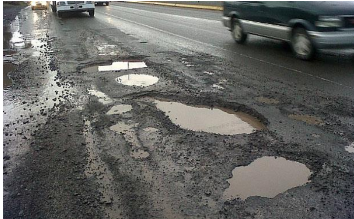
Imagen N°7: Presencia de baches en las vías
