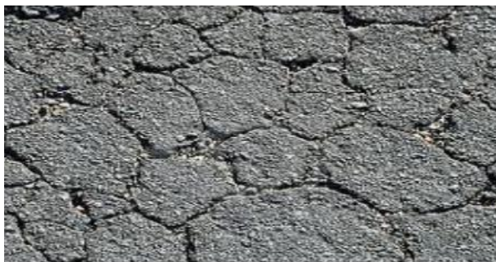
Imagen N°4: Falla piel de cocodrilo
