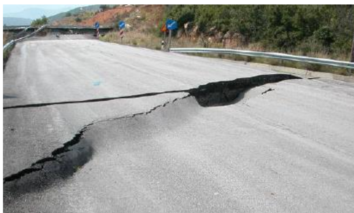
Imagen N°6: Ondulación en la vía
