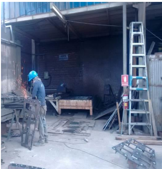
Figura 14. Matricería. Se aprecia corte con amoladora. Se identifica fuente generadora de mayor ruido. Adaptación propia, 2017.
