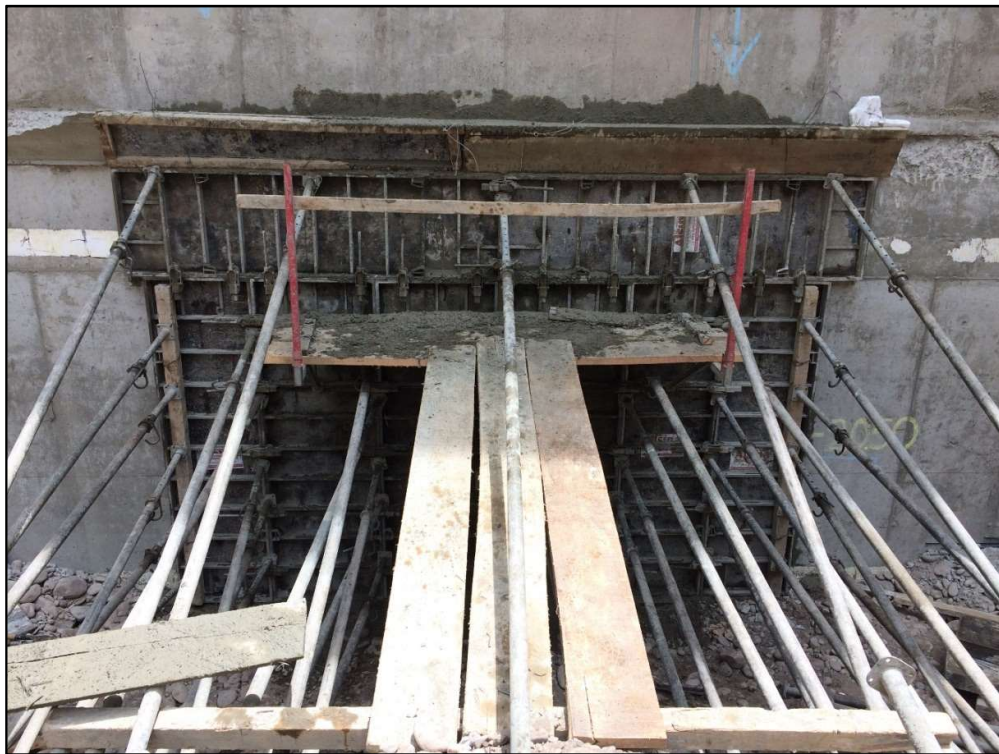
Foto 07: Aquí se aprecia el paño vaciado con concreto con su respectivo encimado de cachimba
