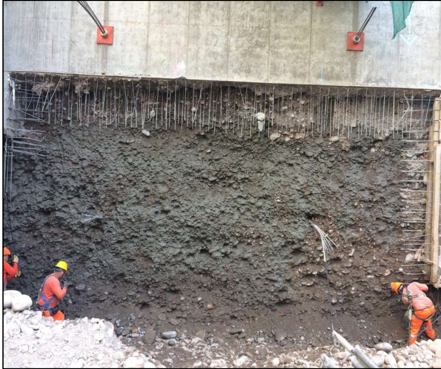
Foto 04: Una vez aperturada la banqueta se procede a perfilar el paño basándose a los puntos que el topógrafo ha colocado como referencia del alineamiento del muro
