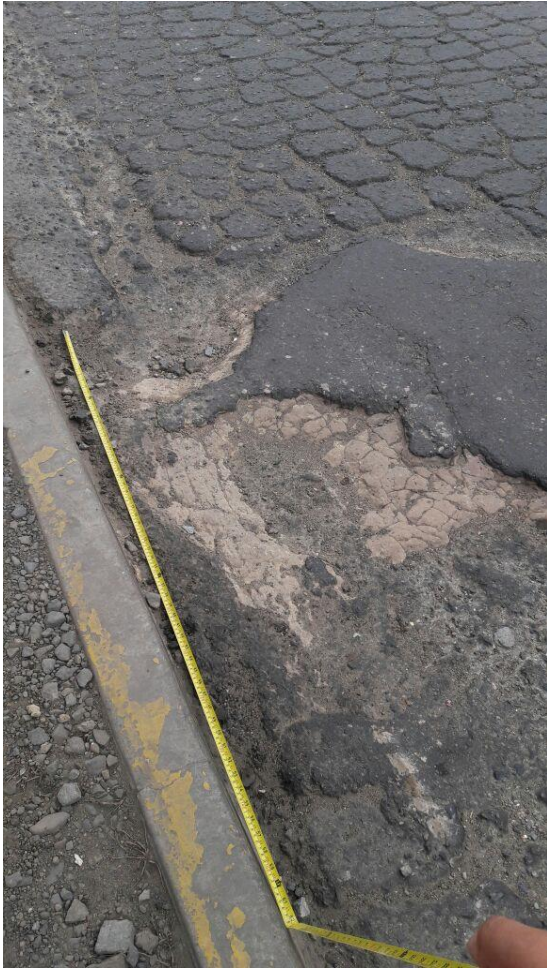
Medición de la severidad de falla
