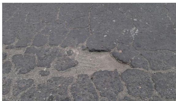
Agrietamiento en bloques
