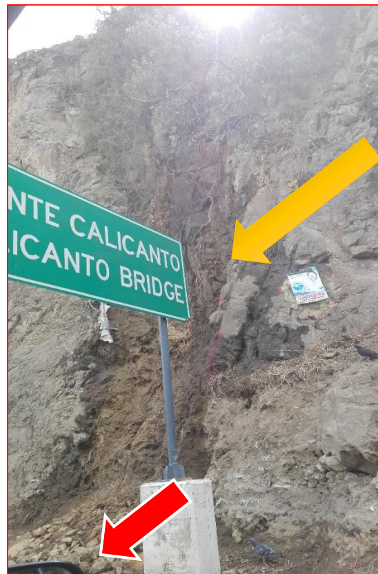
Fotografía 13: fotografía tomada el 22 de octubre del año en curso, temporada de precipitaciones altas en la ciudad de Huaraz, donde la fotografía evidencia la filtración de agua*, por las raíces incrustadas en el macizo rocoso, esta genera el desprendimiento de rocas*.
