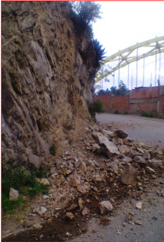
Fotografía 14: fotografía tomada el 22 de octubre del año en curso, temporada de precipitaciones altas en la ciudad de Huaraz, donde la fotografía evidencia el deslizamiento de rocas entre la estación E6 y E7.
