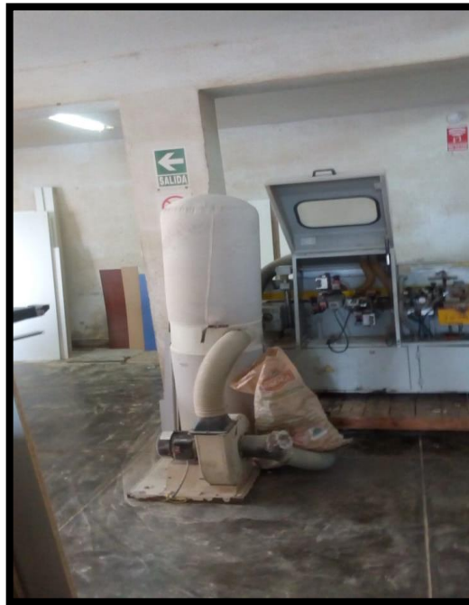
Fotografía 6: Maquina que absorbe los residuos del melamine
