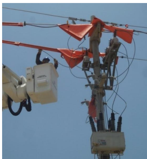
Figura 1.15: conexionado de Recloser
