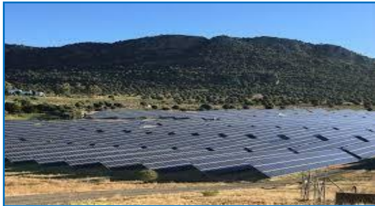
Central de generación fotovoltaica
