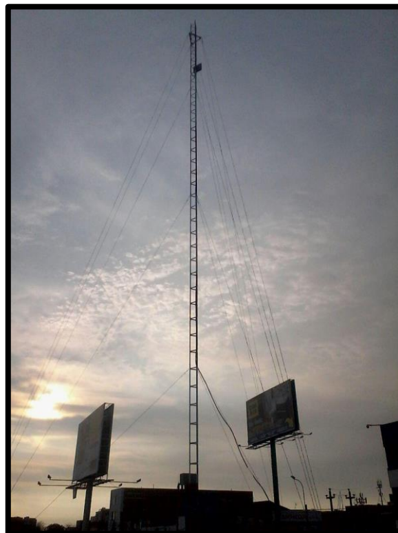
Torre de 15m.
