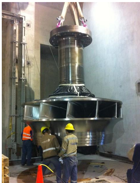
Figura 24: Rodete Francis de 26 toneladas de la central Cerro del Águila
