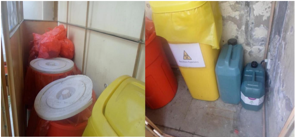
Figura 6. Acondicionamiento del almacén central deficiente, conexión eléctrica en área de destino final
