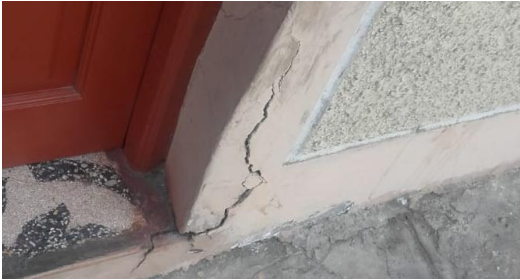
FIGURA 32 falla en columna flexo compresión
