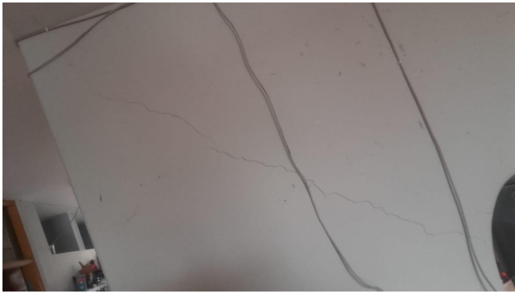
FIGURA 33 agrietamiento falla cortante
