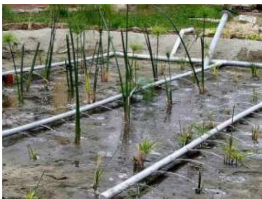
Figura 26: humedal de flujo vertical subsuperficial durante la fase de bombeo. Tomado de: Hoffman, (2006).
