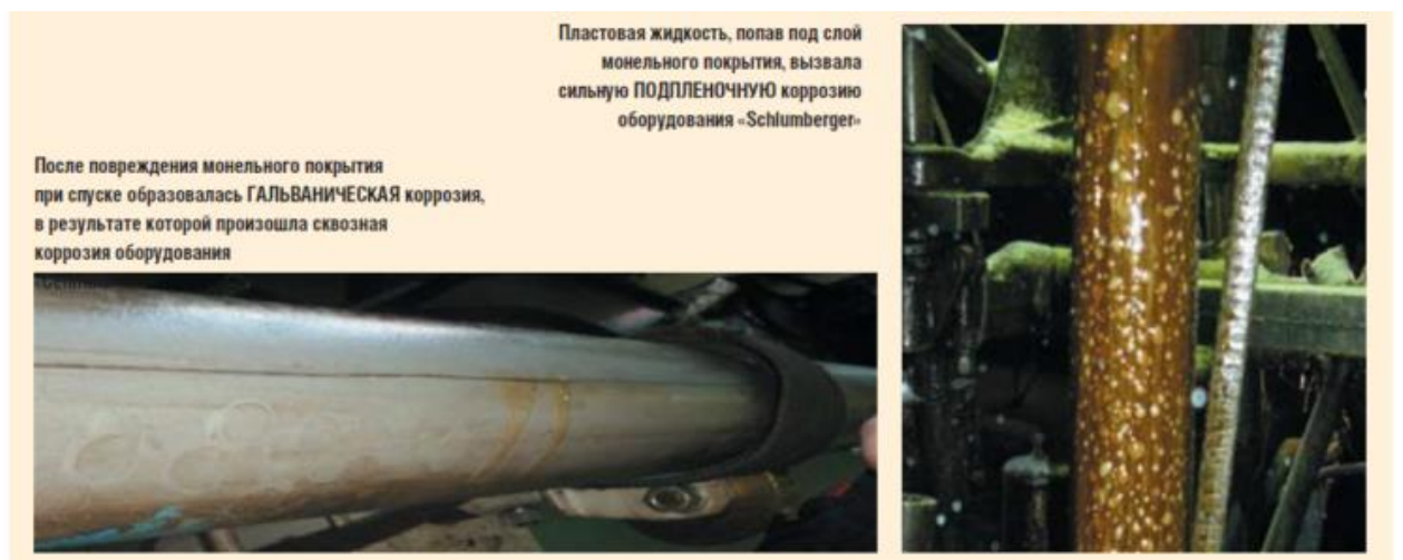
Рисунок 6- Редкие виды коррозии
