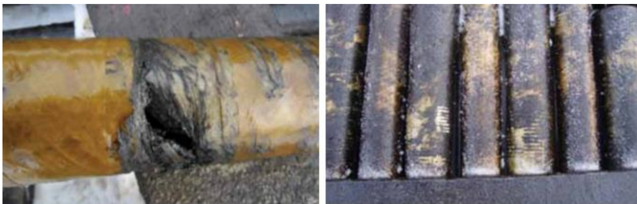
Рисунок 17 – Состояние стеклопластиковых насосно-компрессорных труб после развинчивания при спускоподъемных операциях
