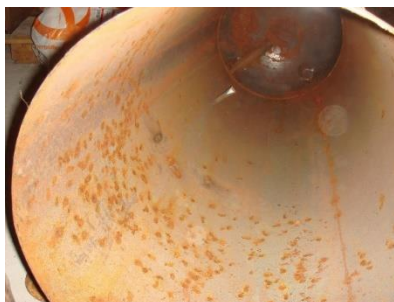
Рисунок 8.1 – Пример коррозии емкости хранения одоранта
