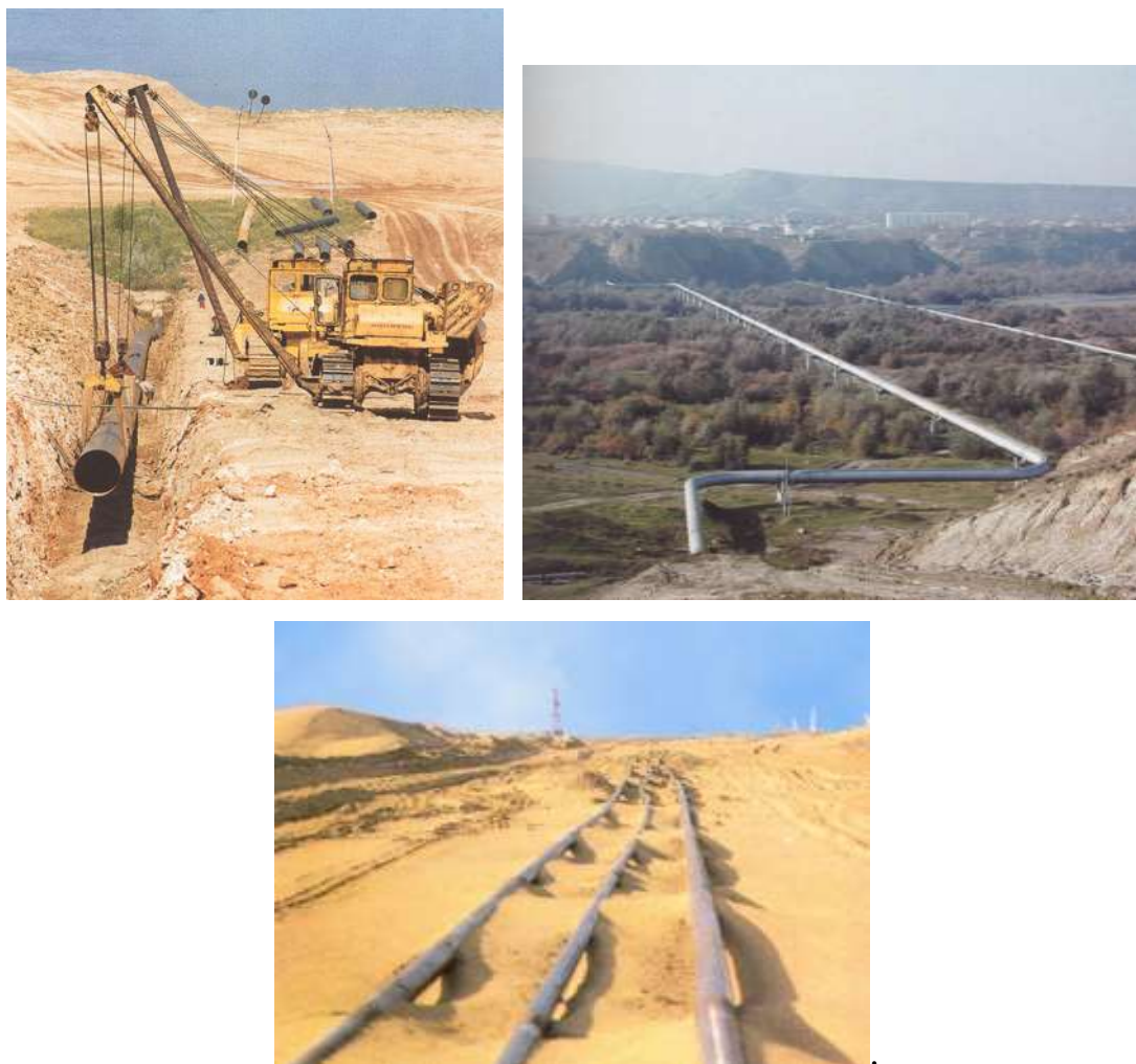
Рисунок 3 – Способы прокладки газопровода: подземный (вверху слева), надземный (вверху справа) и наземный (внизу)[2]
