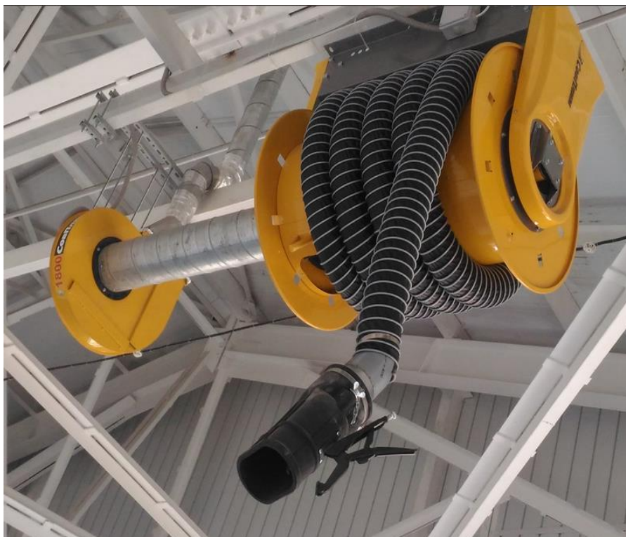
Рис. 2 - Вытяжные катушки для улавливания выхлопных газов
