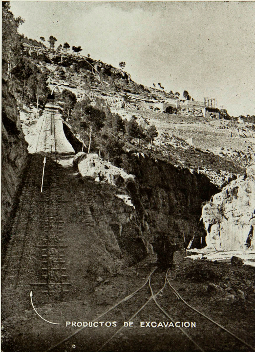
Noviembre de 1943.—Plano inclinado para elevar los productos de excavación a las machacadoras
