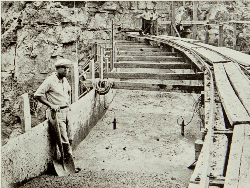
Agosto de 1936.—Colocación de aparatos auscultadores durante el hormigonado del segundo anillo de la ataguia definitiva, sistema «Peña»
