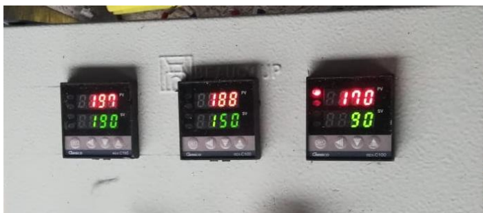
Figura 37. Control de Temperatura
