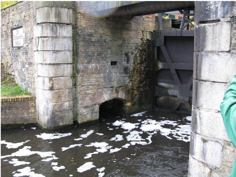
Bild 2: Unterhaupt mit wasserdurchlässigen Fugen, Materialverlust durch Abwitterung und schadhafte Kantensteinenkonstruktion
