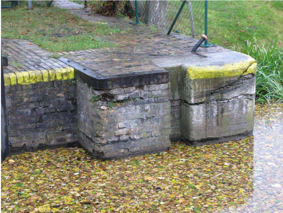
Bild 1: Oberhaupt-Notverschlussnische mit gerissenem Mauerwerk
