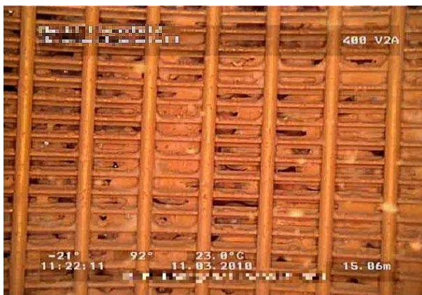
Bild 3: Anlagerung von Eisenhydroxiden an Glaskugeln und in den Schlitzen in einem Wickeldrahtfilterbrunnen. Foto: Fa. Ochs, Nürnberg
