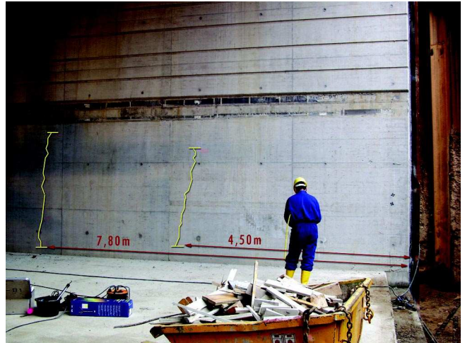
Bild 2.16: Foto der Risskartierung am gleichen Wandabschnitt
