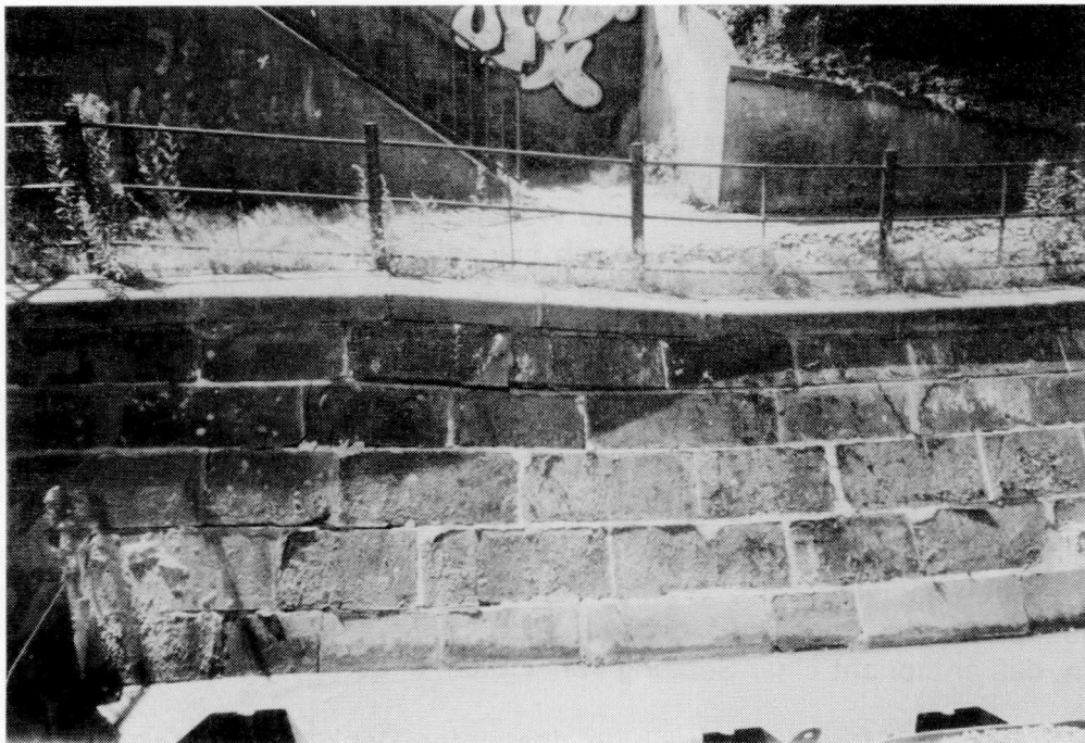
Bild 6 Schäden an der Ufersicherung westlich des südlichen Widerlagers der Potsdamer Brücke
