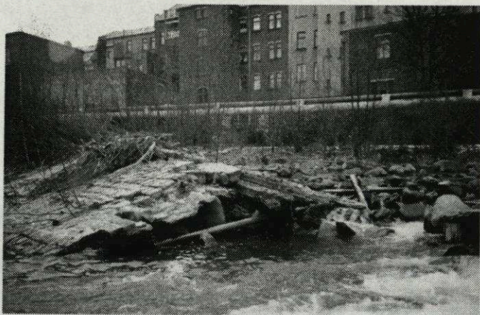
Bild 1: Zerstörtes Textima-Wehr in der Zwickauer Mulde, Aue/Erzgebirge
