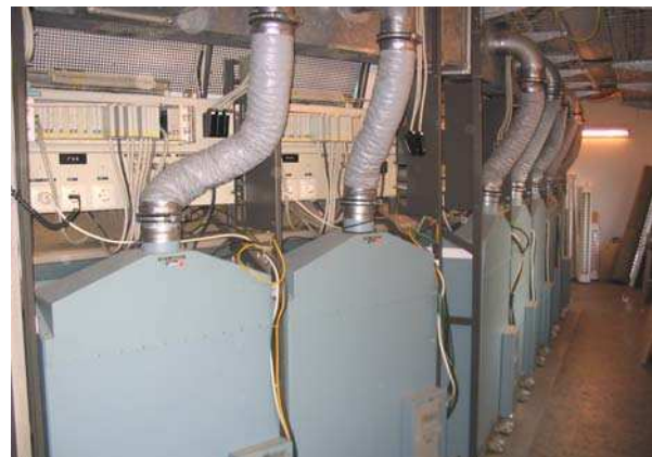
Abb. 3: Rückansicht Sichtgeräte mit Abluftsystem
