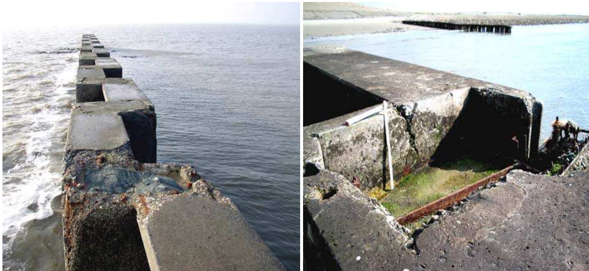
Buhne vor der Instandsetzung
