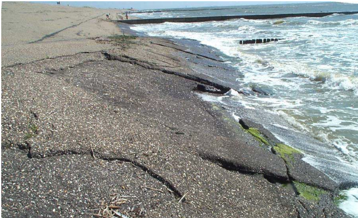
Bauwerksschäden seeseitige Böschung
