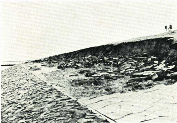
Abb. 11. Beschädigung des Betonsteindeckwerkes im Norden der Insel Nordstrand
