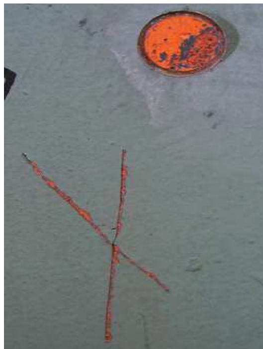
Bild 1: Freigelegte Bruchfläche nach Haftabzugsfestigkeit- bzw. Kreuzschnittprüfung mit oranger giftiger Bleimennige an einem alten Korrosionsschutzsystem
