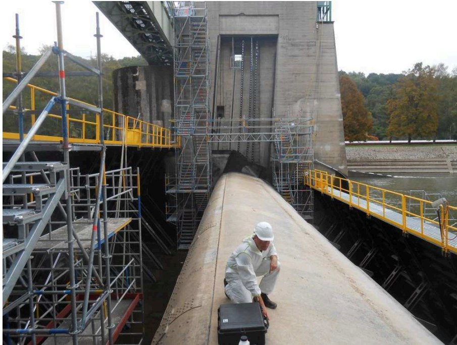
Bild 2: Optische Begutachtung und Beprobung einer PAK-haltigen Beschichtung am Wehrverschluss
