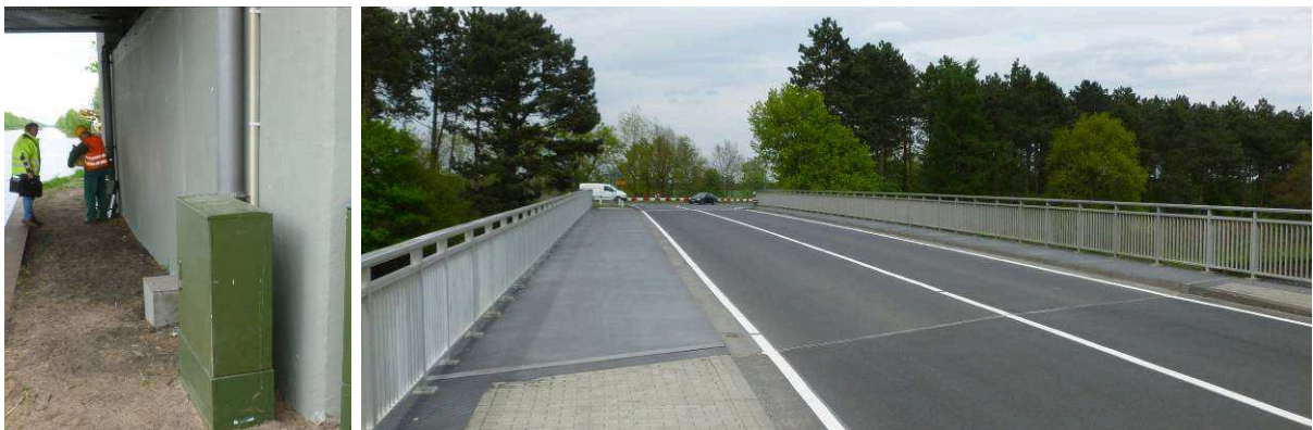
Bild 5: Links: Controller- und Gleichrichterschrank angeordnet im Bereiche einer Widerlagerwand, Rechts: Ansicht der Brückenoberseite nach Abschluss der Grundinstandsetzung der Brücke
