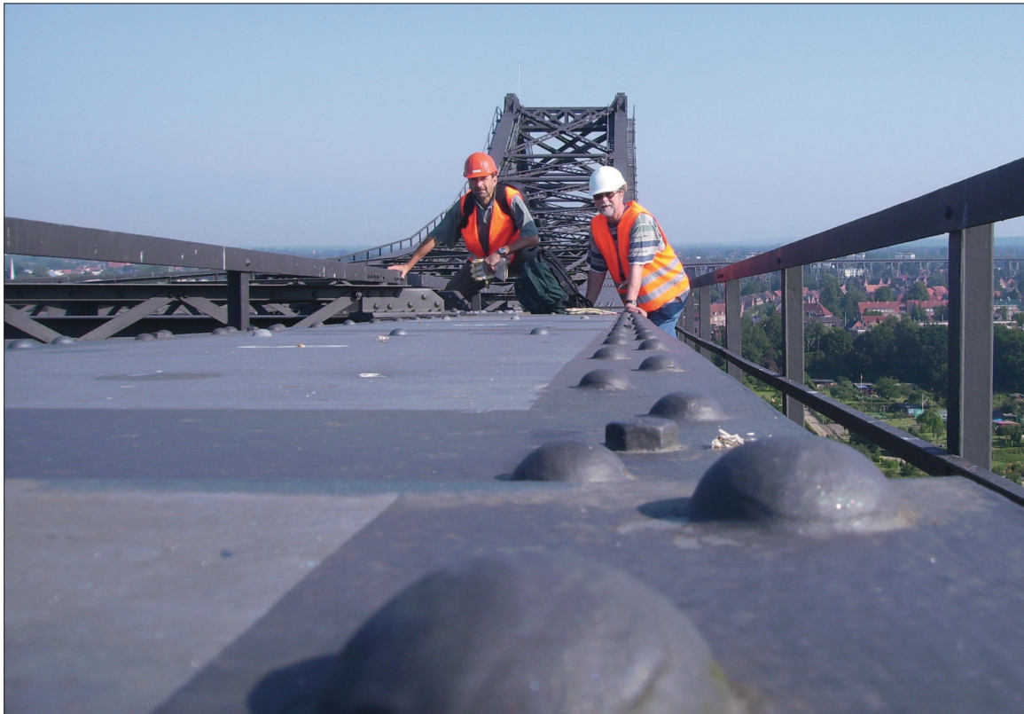
Bild 1.5: Überprüfung des Korrosionsschutzes an der Eisenbahn- hochbrücke in Rendsburg (NOK) Figure 1.5: Examination of the corrosion protection at the railway viaduct in Rendsburg (Kiel- Canal)
