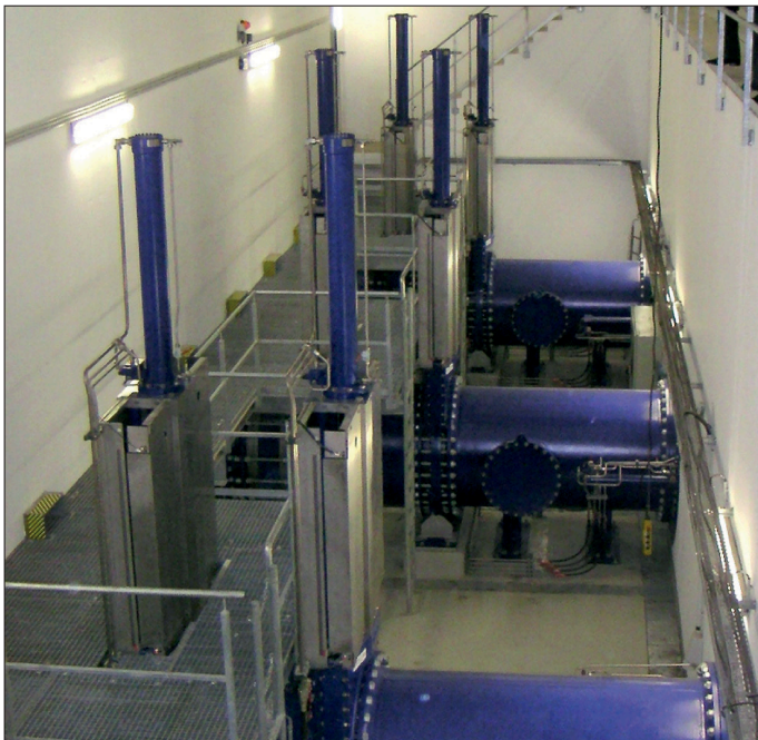
Bild 5.3: Pumpenzentrale an der Kanalbrücke Minden (MLK)
