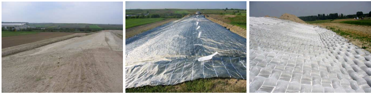
Abbildung 4: Vorbereitetes Planum; Verlegung des vorkonfektionierten Betonmatten-Gewebes; Zustand nach Installation und Befüllung (von links nach rechts)
