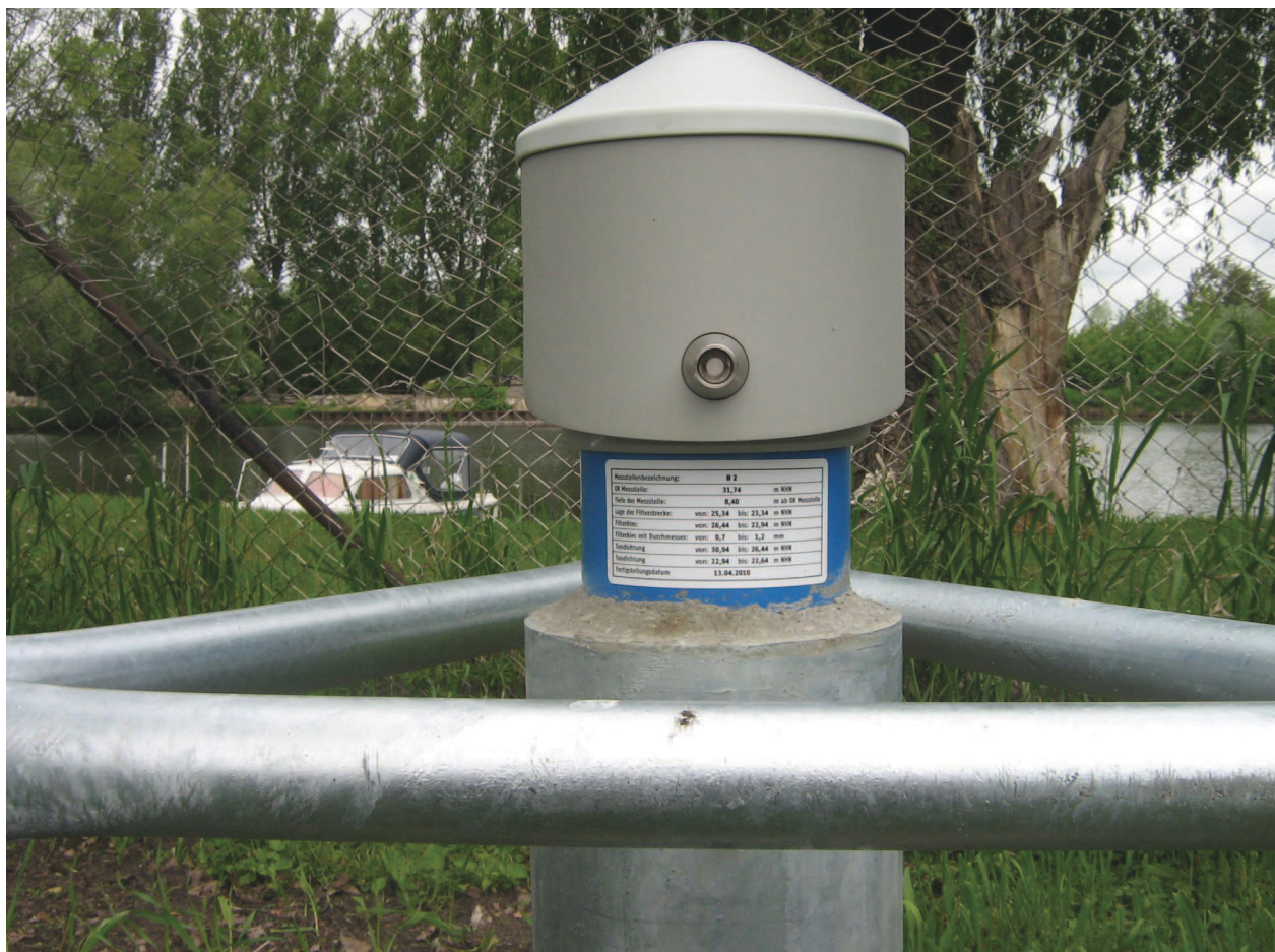
Bild 2: Grundwassermessstelle am Havelkanal mit einer Brunnenkappe OTT-ITC
