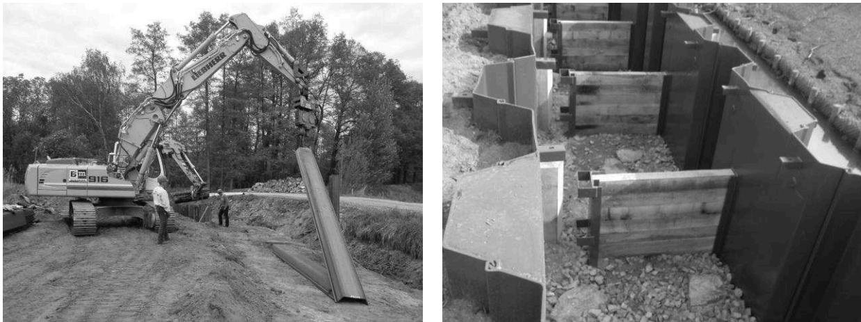
Abbildung 2: Links: Vorbereitung zum Einbringen der Spundbohlen mittels Vibrationsramme, rechts: Schlitzpass mit Spundwänden als Tragkonstruktion
