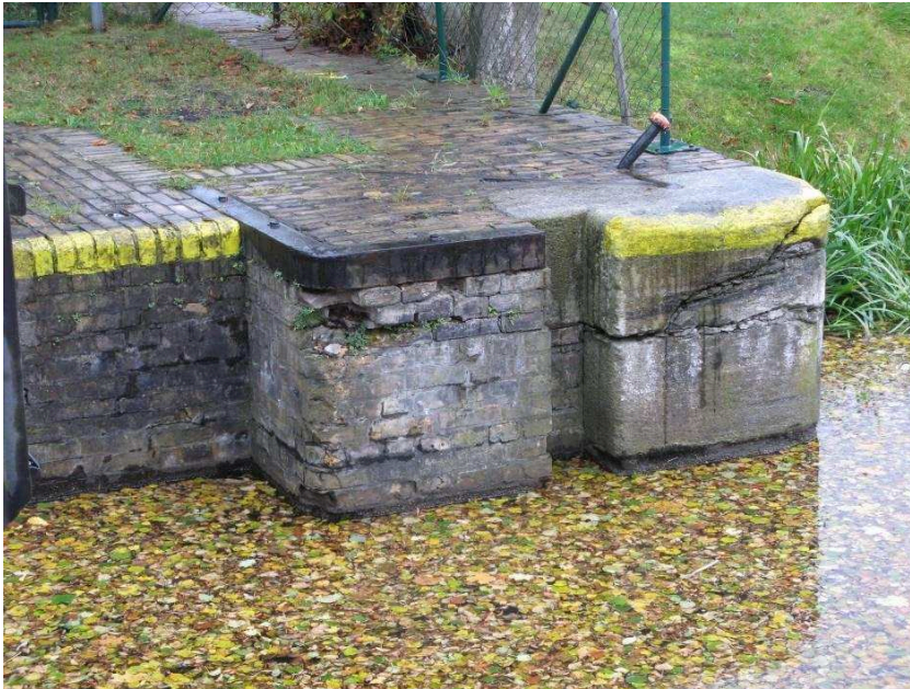
Bild 1: Oberhaupt-Notverschlussnische mit gerissenem Mauerwerk
