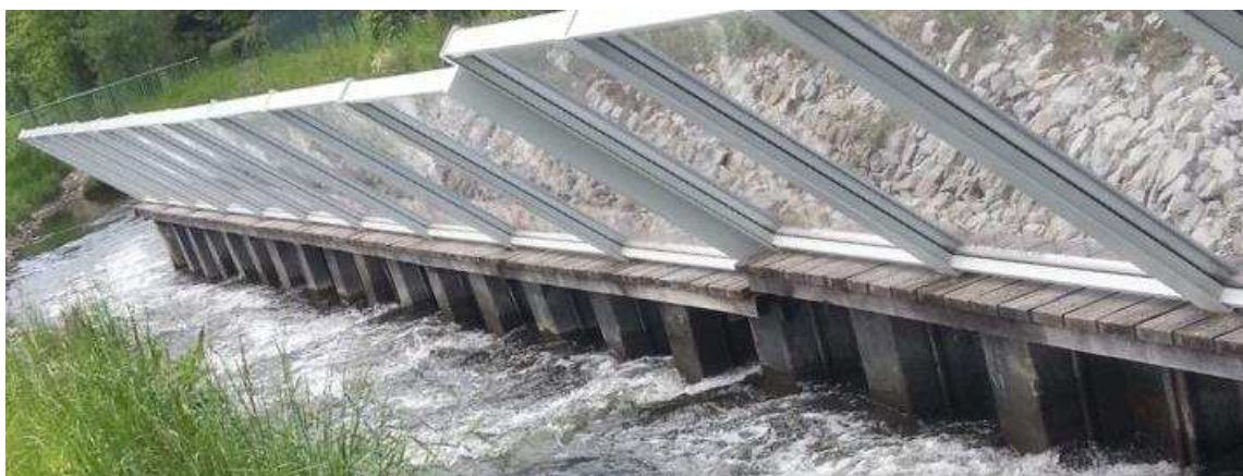
Abbildung 1: Genaigte Schallschutzwand an Fischaufstiegsanlage
