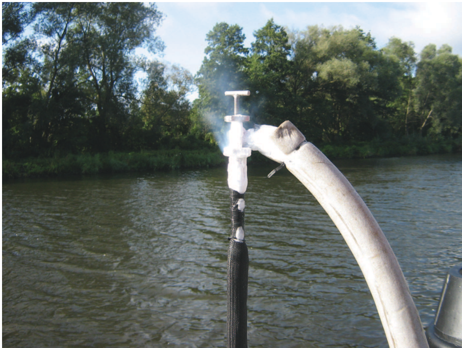
Bild 4: oberer Abschluss des Hohlgestänges mit isolierter Stickstoffzuleitung und ausströmendem Stickstoffgas
